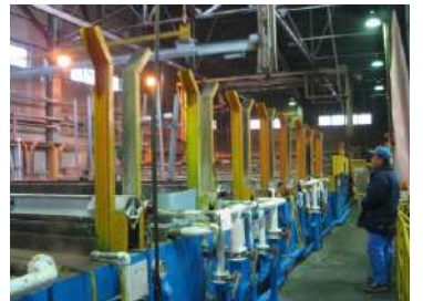
【工場内のカチオン電着塗装設備】
