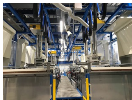
新工場に設置したワンマンコントロール式全自動装置
