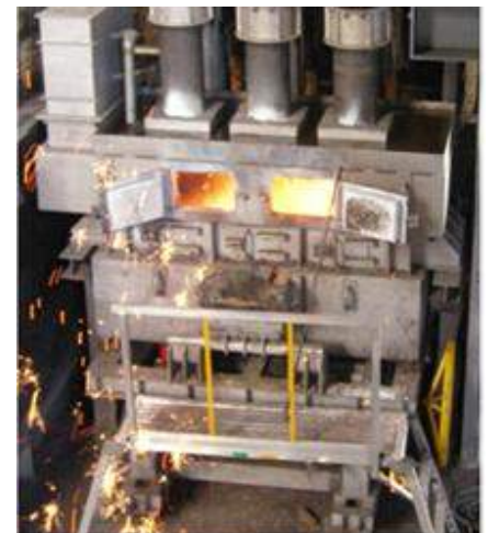
＜KS 式電気炉＞
