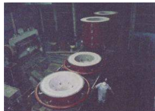
電力発電用耐火炉 内面:耐火煉瓦貼り
