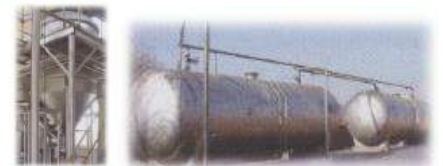
バイオマスガス化プラント
