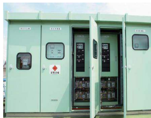
<CO 2 削減推進型キュービクル>
